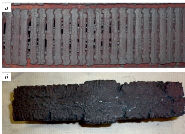
Рис. 1. Колосники после шести месяцев эксплуатации: а – установленные на обжиговой тележке, б – средняя часть демонтированного с балок колосника, вид сверху
